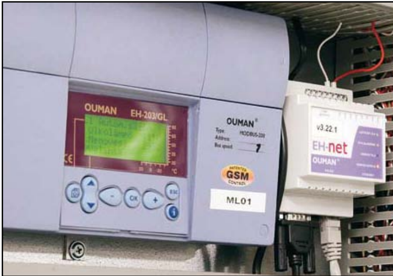
Kuva 3. Ouman EH-net -palvelin asennettuna EH-203 –lämmönsäätimen yhteyteen
